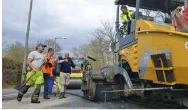
Die Einbauleistung lag bei 45,6 t pro Stunde gegenüber den zuvor geplanten 43 t pro Stunde. Dabei wurden insgesamt 195,2 t Asphalt verarbeitet.
