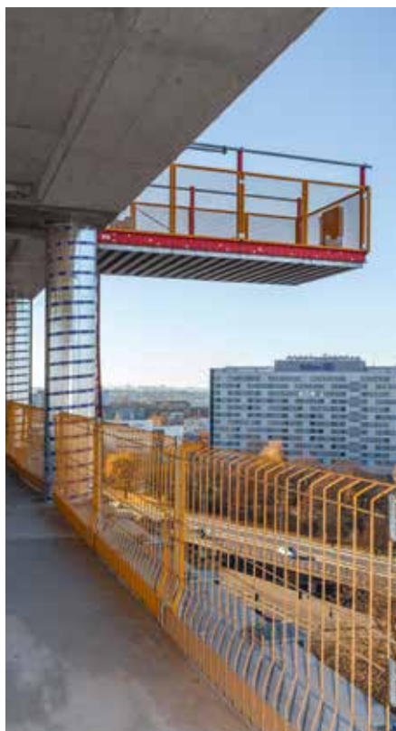
Die umlaufende PROKIT Absturzsicherung und auskragende RCS MP Ausfahrbühnen ergänzten das Peri Schalungskonzept sinnvoll.
