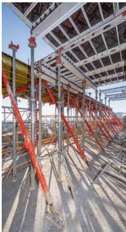
Zum Schalen der Geschossdecken wurden die VARIODECK Randtische mit der SKYDECK Panel-Deckenschalung kombiniert. Bilder: Peri
