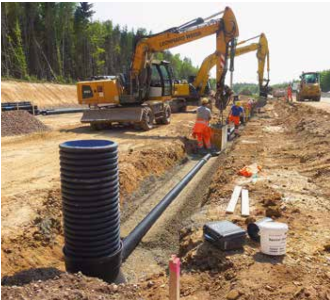
Etwa 160.000 m Strabusil Sickerleitungsrohre von Fränkische transportieren das Drainage- bzw. Sickerwasser auf dem Teilabschnitt der A3 in Unterfranken.
