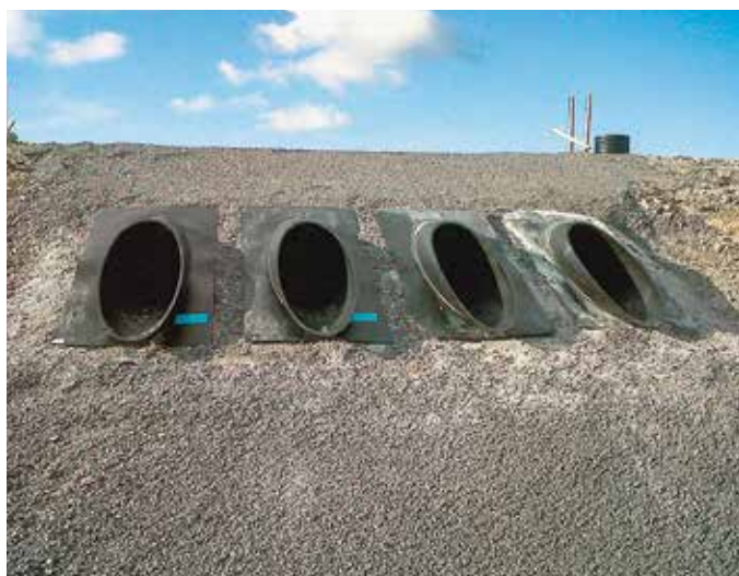
Um die AquaPipe-Rohre dicht an das Absetzbecken mit Betonauskleidung anzuschließen, kamen AquaPipe-Sonderformteile von Fränkische als Foliendurchdringung zum Einsatz. Bilder: Fränkische
