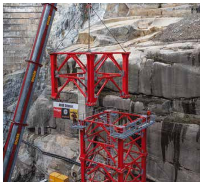
Für das Projekt entwickelte Wolffkran das 6 x 6 m Turmelement TV 60. Dank seiner Dimensionen können die Wipper auch bei extremen Wetterverhältnissen über 90 m freistehen und Lasten bis 20 t heben.
