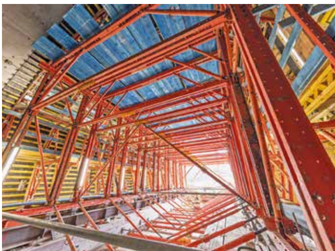
Der Peri-Tunnelschalwagen basierte auf dem VARIOKIT Ingenieurbaukasten mit mietbaren Systemkomponenten. So konnte in kürzester Zeit eine maßgeschneiderte Projektlösung erarbeitet werden. Bilder: Peri
