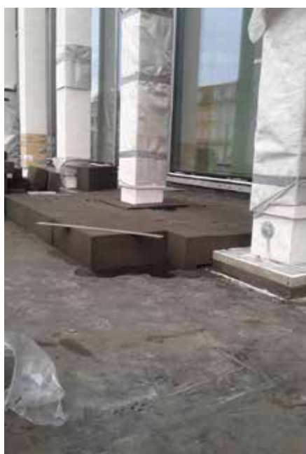
Der Schichtaufbau besteht aus Schaumglasdämmplatten Foamglas T3+ und T4+ mit einer entsprechenden zweilagigen Abdichtung.
