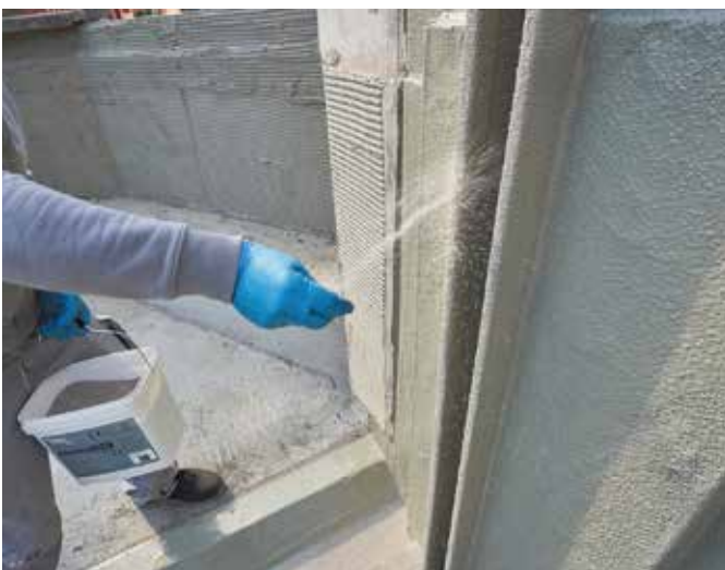
Nach der Abdichtung wurden die Bereiche, die später die Sichtfenster einschließen, abschließend mit Quarzsand eingesandet.
