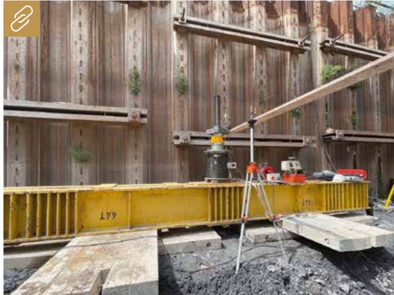
Das terra ASF Mikropfahlsystem bei der Pfahlprobebelastung: Die geforderte max. Prüflast von 2.960 kN wird problemlos von diesem System aufgenommen. Bilder: Terra Infrastructure
