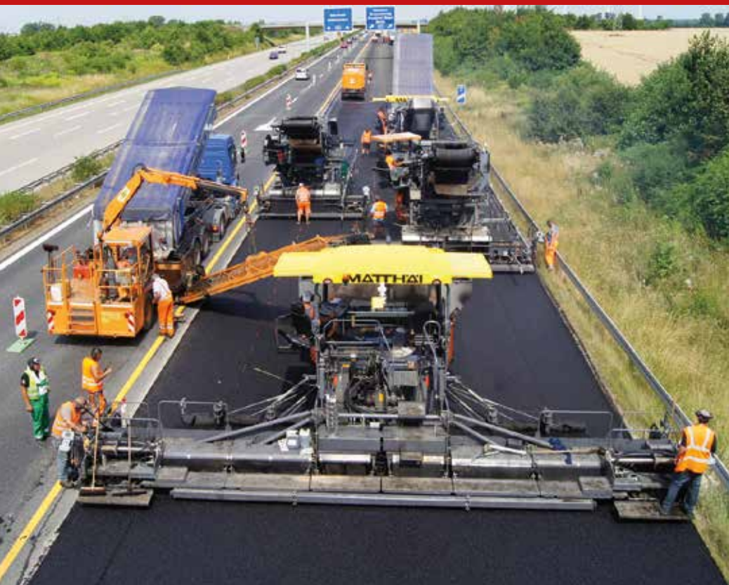
Ein Seitenbeschicker von Rumpel rollt links neben der Fertigerspur auf der Fahrbahn und beschickt mit dem Schwenkband einen Fertiger beim heiß-auf-heiß-Einbau mit 10,5 m Einbaubreite. Bild: Rumpel
