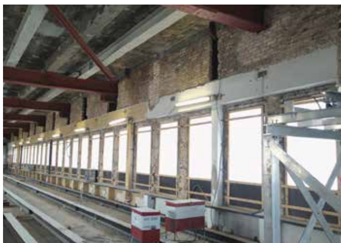
Die oberen Rollladenkästen waren der Bezugspunkt für die Lotrechte, ab der mit dem Armierungsmörtel maxit eco 79 begonnen wurde.
