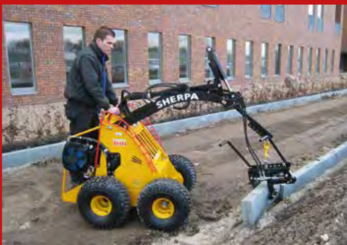
Der im Stehen bediente Sherpa 100 arbeitet wahlweise mit Betonmischer, Vakuumheber oder sogar am Schnellwechsler aufgesattelttem Dumper. Bilder: Weber Baumaschinen
