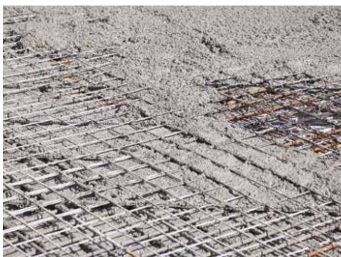
Mit der Carbonbewehrung sind leichtere und schlankere Bauteile herstellbar. In Dresden genügte eine Betonüberdeckung von nur 2 cm. Das reduziert die Baukosten und wirkt sich positiv auf die Umwelt aus.
