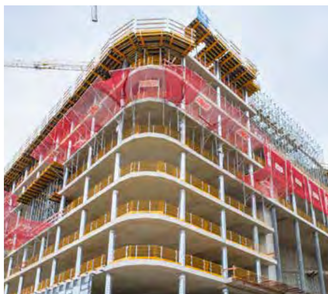
Absturzsicherheit: Für ein sicheres Arbeiten an den Rändern wurden beim „Eclipse“ in Düsseldorf MBP-Gitterelemente eingesetzt.
